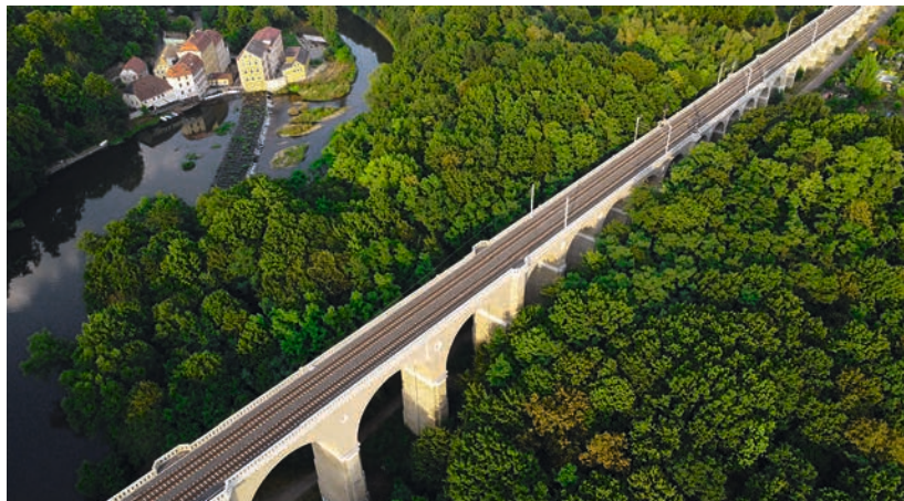
Polen hat die Strecke elektrifiziert, Deutschland bisher nicht. Und so enden die Strommasten mitten auf der Brücke über den Grenzfluss zwischen Görlitz (DE) und Zgorzelec (PL).
