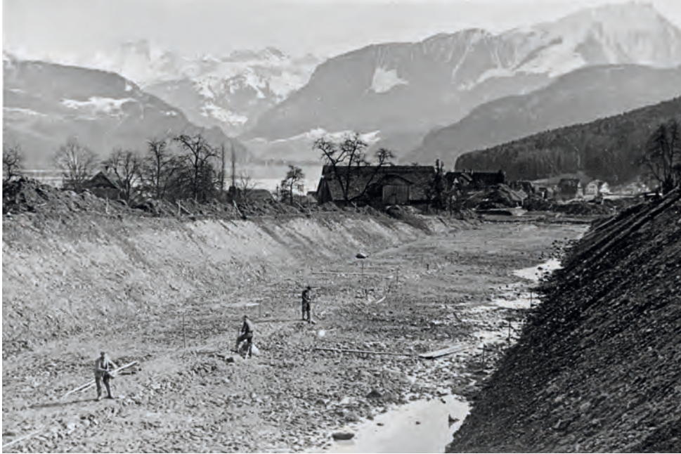
Bau der ersten Autobahnstrecke der Schweiz, gegen 1954. Das Werk kostete sieben Millionen Franken, wovon 60 Prozent vom Bund übernommen wurden.
